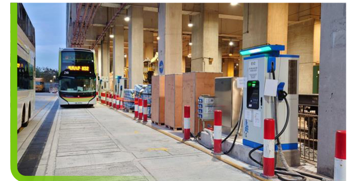
全新電動巴士已投入服務，並於屯門車廠增設充電站
